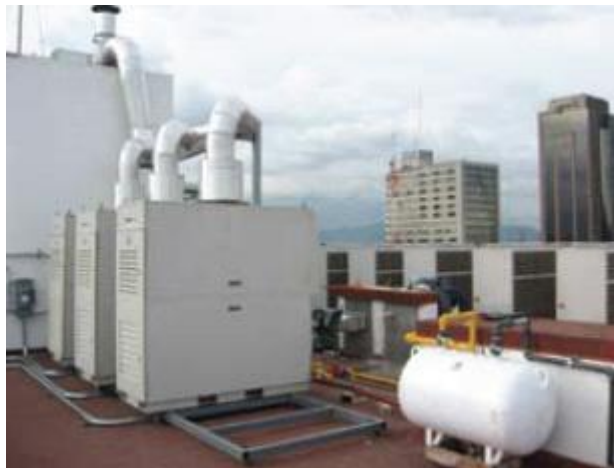
Figura 1- Micro-turbinas a gás em hospital na Cidade do México
